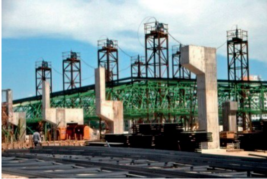
รูปที่ ๔๑ ที่รองรับโครงหลังคาทำเป็นเสา ชั้นไปรับ ซึ่งเสาชั้นล่างมีตำแหน่งไม่ตรงกับเสา ที่รับหลังคา จึงมีรูปร่างอย่างที่เห็นในภาพ
