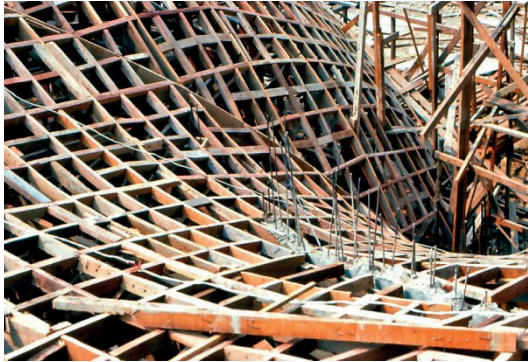
รูปที่ ๒๕ ไม้เคร้ารองรับแบบหล่อคอนกรีต ซึ่งยุ่งยากมาก
