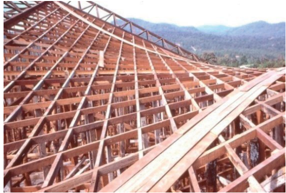
รูปที่ ๑๔ การสร้างไม้คร่าว ไม้แบบที่สร้างจริง
