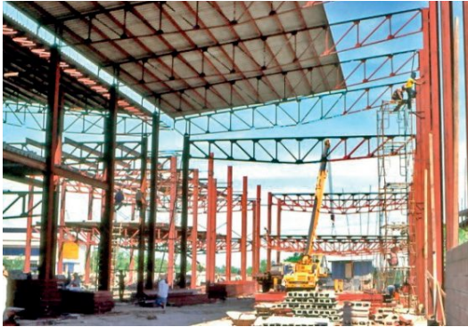
รูปที่ ๓๒ โครงรับหลังคาโรงงาน ชนิด ๒ มิติ ทำด้วยเหล็กรูปพรรณ
