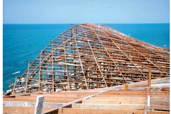
รูปที่ ๑๒ โครงคร่าวของหลังคาแบบอานม้า ประกอบด้วยเส้นตรงทั้งสิ้น
