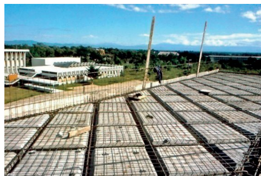
รูปที่ ๕๑ การผูกเหล็กเสริมสมบูรณ์พร้อมเทคอนกรีต
