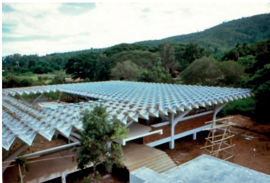
รูปที่ ๖๗ แสดงพื้นที่ทั้งหมดของหลังคาสังเกตดี ๆ จะเห็น compression members ทำด้วยท่อเหล็กออบสังกะสี
